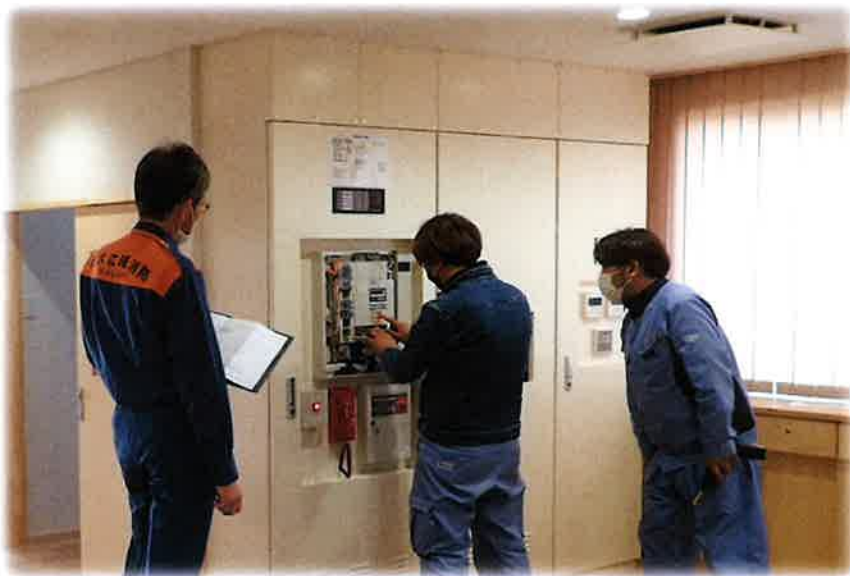
《消防用設備検査》
