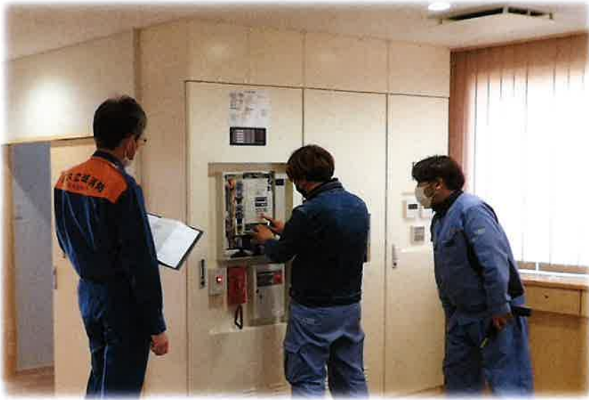
《消防用設備検査》
