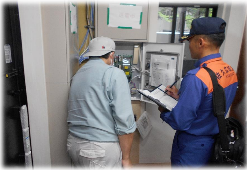
《消防用設備検査》
