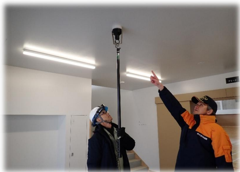
《 消防用設備検査 》
